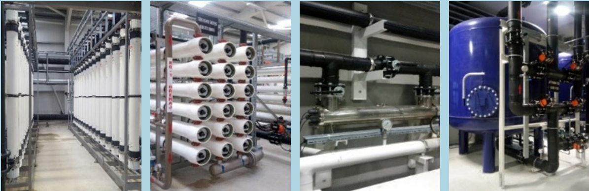
Şekil 4.11: AKOSB AAT ileri arıtma üniteleri (Ultrafiltrasyon, Aktif Karbon, Ters Osmoz ve Ultraviyole Dezenfeksiyon)
